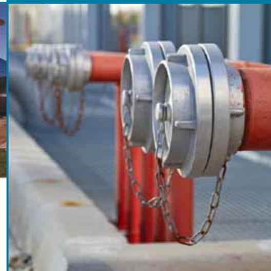
CIRCUTOR-CIRCONTROL VILADECAVALLS (BARCELONA). PRODUCCIÓN Y EDIFICIO CORPORATIVO Torrella Ingenieros
